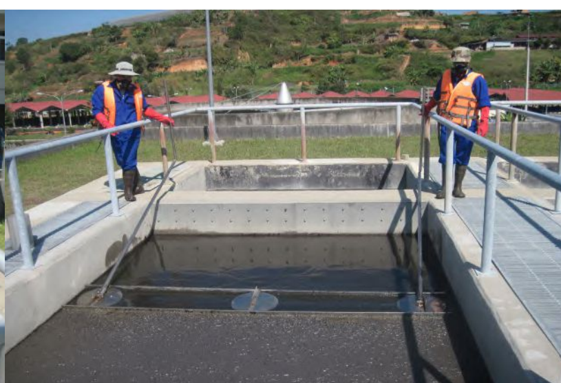
Thu gom màng bọt qua hệ thống bể lắng Imhoff
