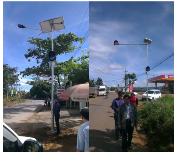
Trụ đèn cảnh báo giao thông kết hợp đèn chiếu sáng
