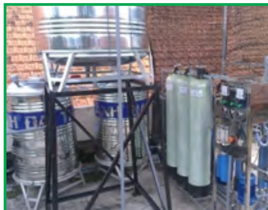
Hệ thống xử lý nước cấp sinh hoạt và lọc nước tinh khiết
