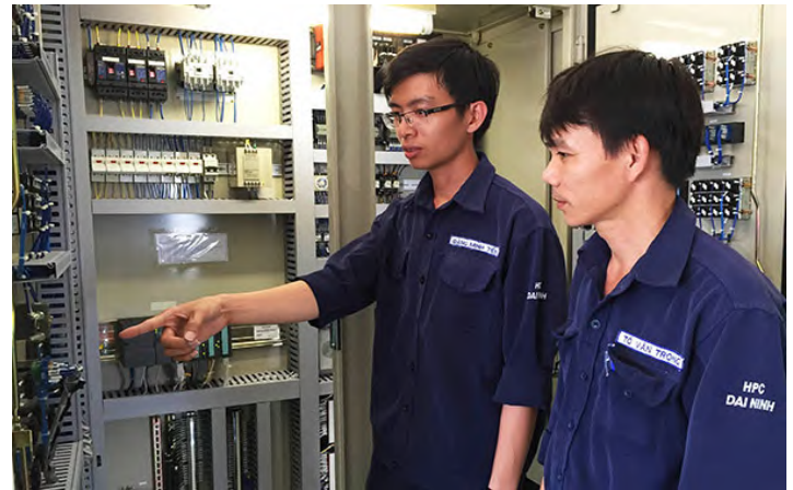
Nhóm kỹ sư trẻ bên hệ thống truyền dẫn tín hiệu cáp quang vận hành tại Nhà máy Thủy điện Đại Ninh
